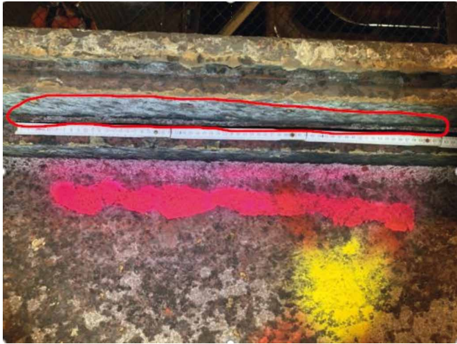
Bild 8 Beispiel: Riss im Schweißnahtübergang Längsnaht zwischen Lamellen Example: longitudinal crack at weld toe between flange plates
