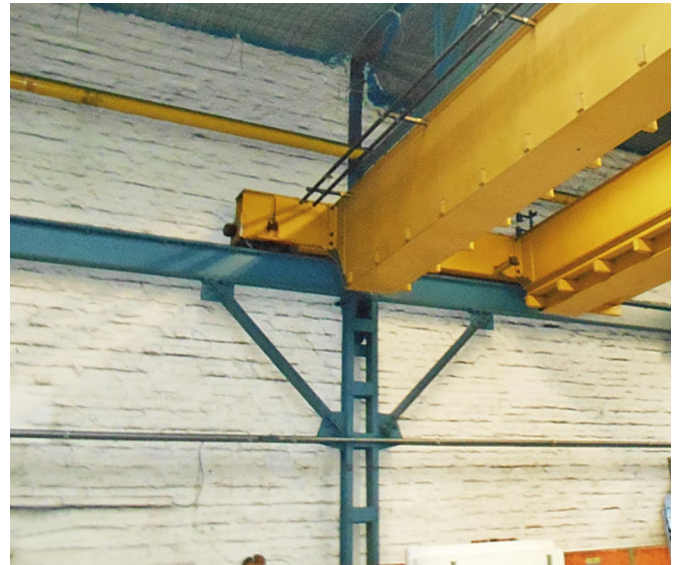
Bild 3 Beispielhafte Bestandskranbahn mit Unterbaukonstruktion Existing crane runway beam with its supporting structure
