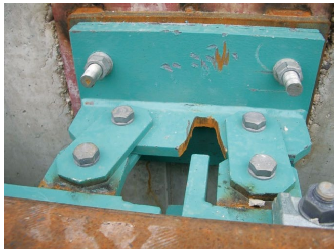
Bild 11 Unsachgemäße Ausnehmung an einer Kranbahnträgerhorizontalhalterung Inappropriate execution at a horizontal fixing of a crane runway beam
