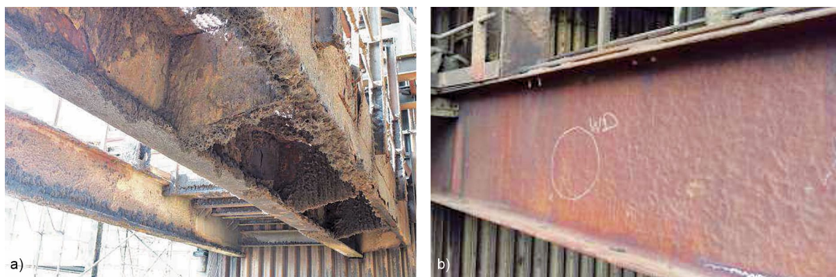
Bild 7 a) Beispielhafte stark verschmutzte Bestandskranbahn, b) zur Inspektion gereinigte Kranbahn a) Example of strongly contaminated existing crane runway beam, b) before inspection cleaned crane runway beam
