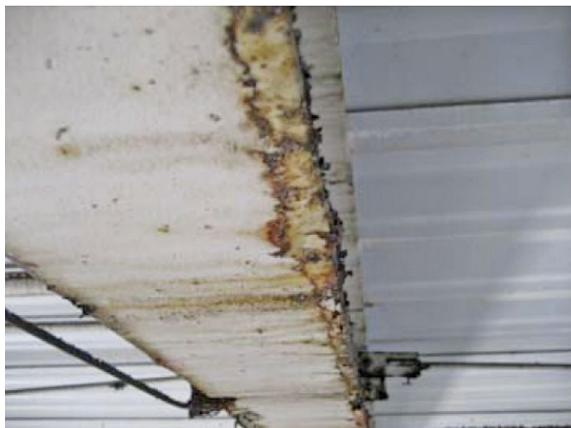
Bild 10 Großflächiger Korrosionsschaden an einem Stahlträger Large area of corrosion at a steel beam
