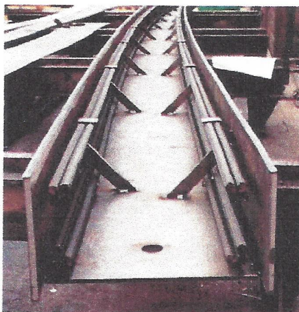
Bild 2. Offener Stahlkasten mit innenliegender Bewehrung und Öffnung im Blech zum Anschweißen des Betoneinfüllstutzens (© Werksfoto Vollack Bautechnik®)
